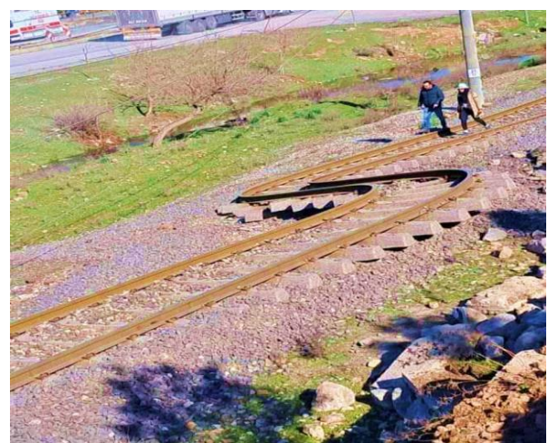
Μετατόπιση τουλάχιστον 2 μέτρα της σιδηροδρομικής τροχιάς μετά το σεισμό του 2023 M7.8 στην Τουρκία σε τμήμα του ρήγματος οριζόντιας ολίσθησης της Ανατολικής Ανατολίας.
